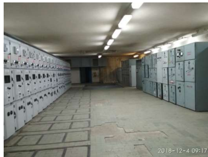
Фото 4. Помещение центрального распределительного устройства 6 кВ. Токтогульской ГЭС
