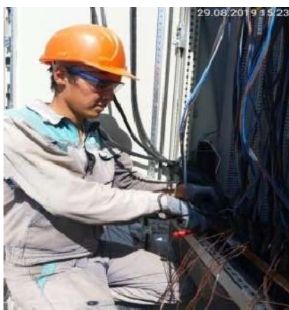
Рисунок 32. Рабочий в СИЗ на подстанции 500 кВ Токтогульской ГЭС (статус в августе 2019 г.)
