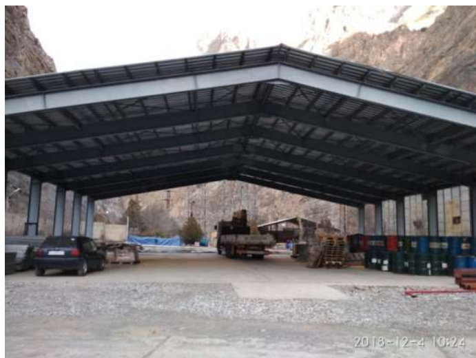
Фото 3. Участок маслохранилища Токтогульской ГЭС
