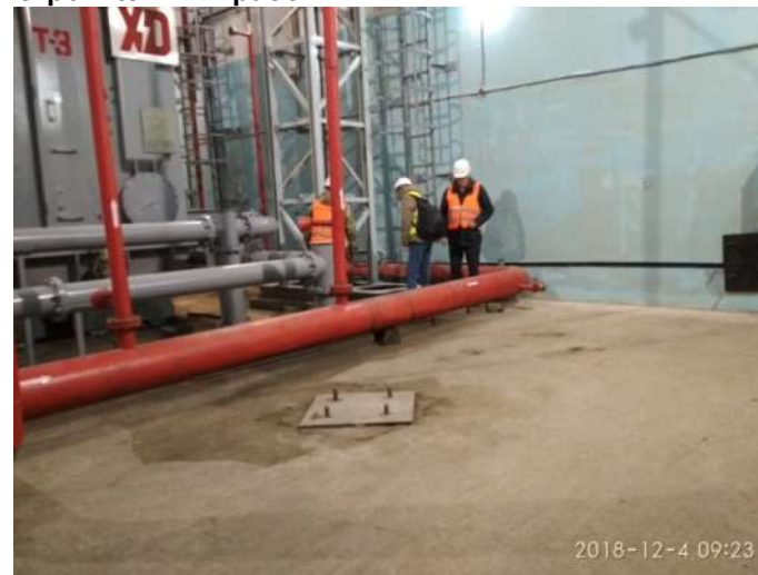
Фото 2. Помещение основного трансформатора Т3 Токтогульской ГЭС
