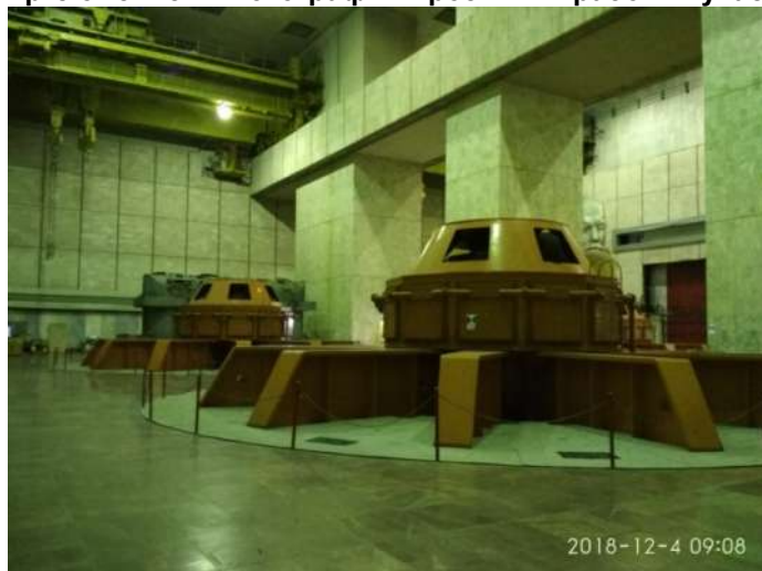
Фото 1. Машинный зал Токтогульской ГЭС
