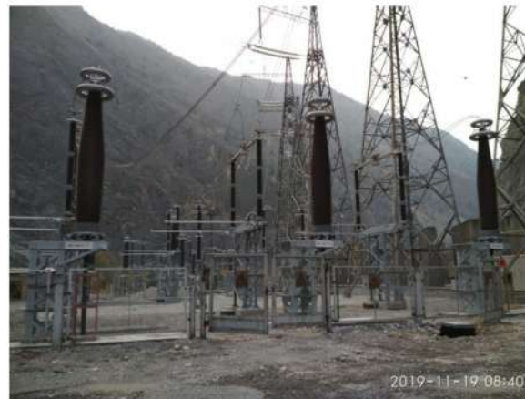
Фото 4. Участок пункта перекидки 500 кВ. Токтогульской ГЭС (Статус – ноябрь 2019г.)
