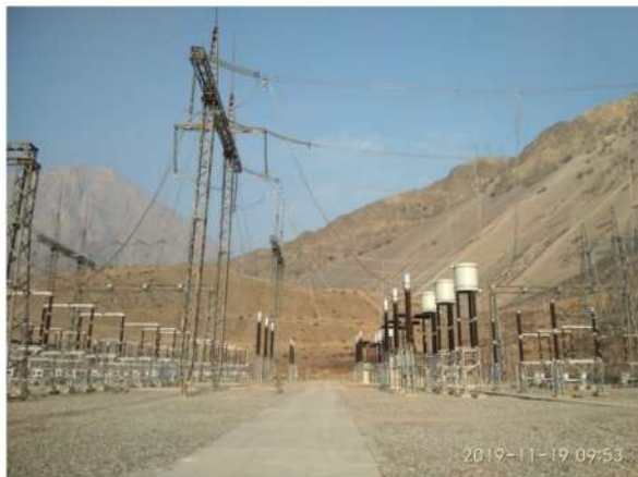
Фото 1. Участок ОРУ 500 кВ. Токтогульской ГЭС (Статус – ноябрь 2019г.)
