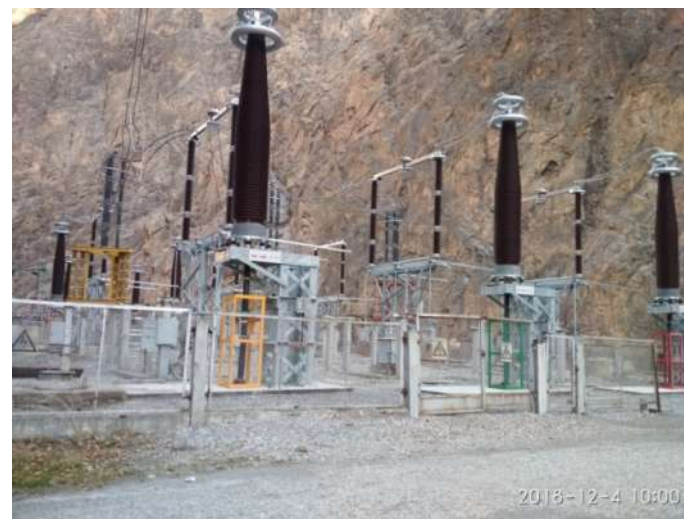
Фото 2. Участок Пункта перекидки 500 кВ. Токтогульской ГЭС
