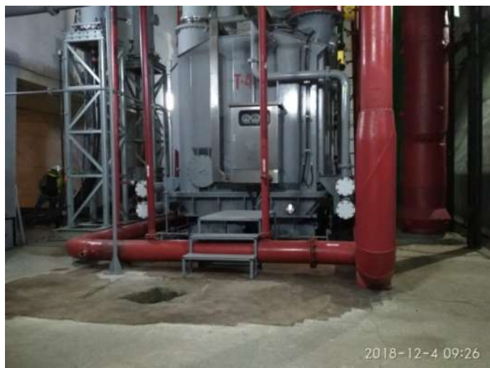
Фото 3. Помещение основного трансформатора Т4 Токтогульской ГЭС
