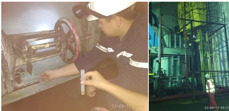
Рисунок 29. Отбор пробы масла с главного трансформатора Агрегата 2 Токтогульской ГЭС
