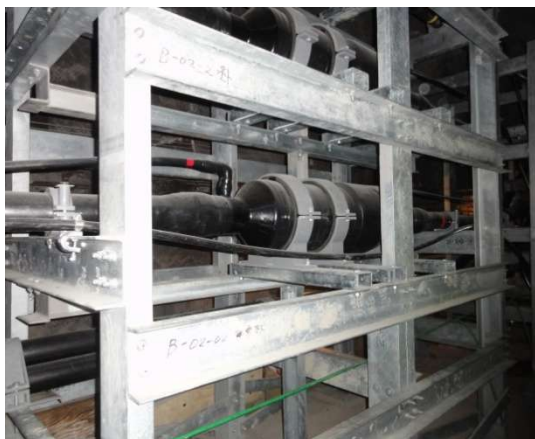
Рисунок 7. Кабельный соединитель нового кабеля 500 кВ - Статус на декабрь 2017 года.
