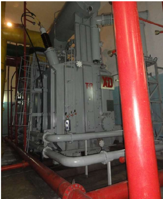
Рисунок 2. Новый главный трансформатор эксплуатируется с августа 2017 года - Статус на сентябрь 2017 года.
