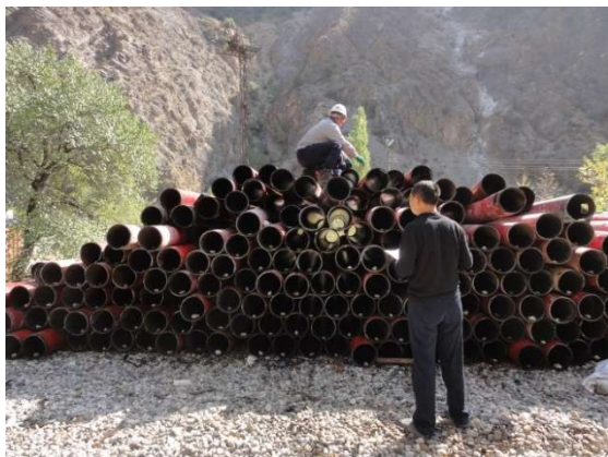
Рисунок 20. Демонтированные металлические трубы кабеля 500 кВ готовые к утилизации - статус на сентябрь 2017 года.
