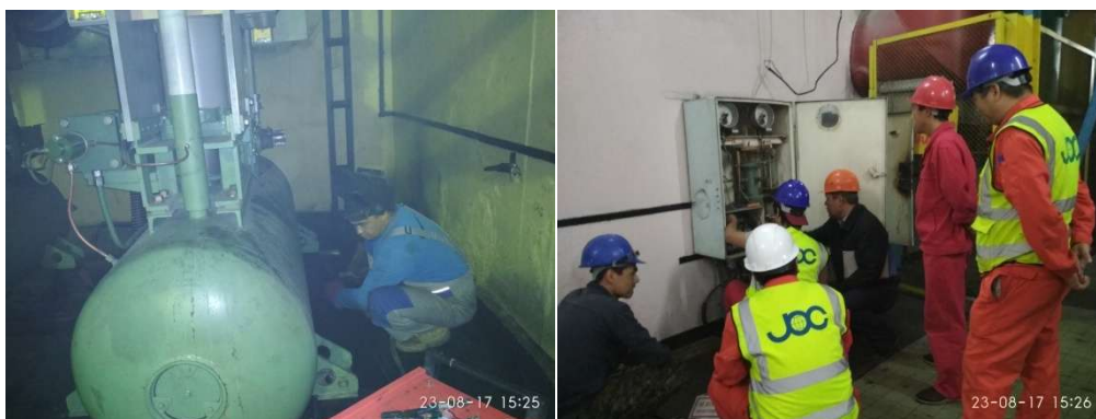
Рисунок 9. Работники китайской компании выполняют работы в СИЗ и требования ОТОС - август 2017 г.
